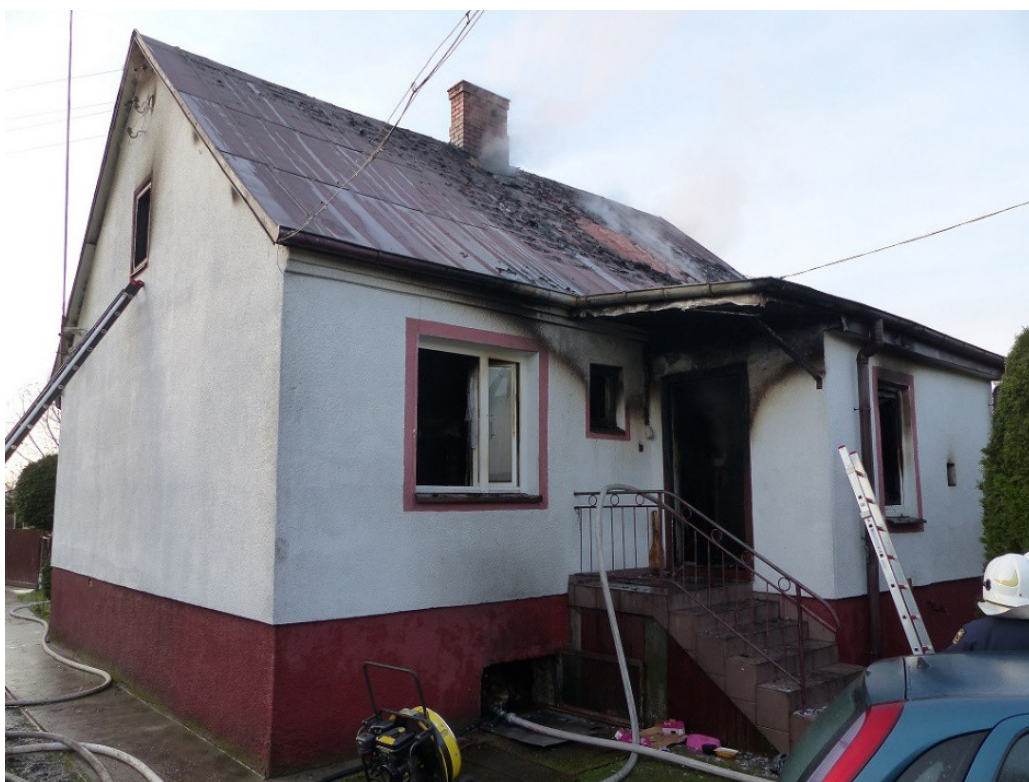
18.04.2017 Hajnówka, ul. Zajęcza 61. Pożar budynku mieszkalnego (1 osoba śmiertelna) Całkowitemu wypaleniu uległo wnętrze budynku wraz z wyposażeniem.
